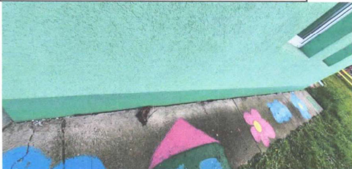
Neetanșeitati ale trotuarului de garda – contrapanta + lipsa dop de bitum
