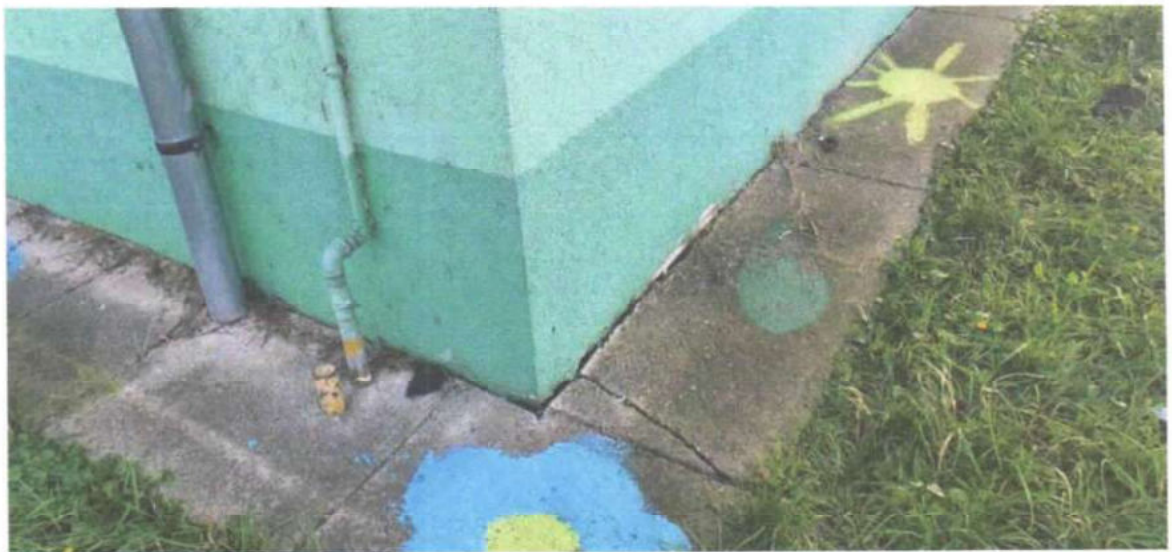
Neetanseitati ale trotuarului de garda
