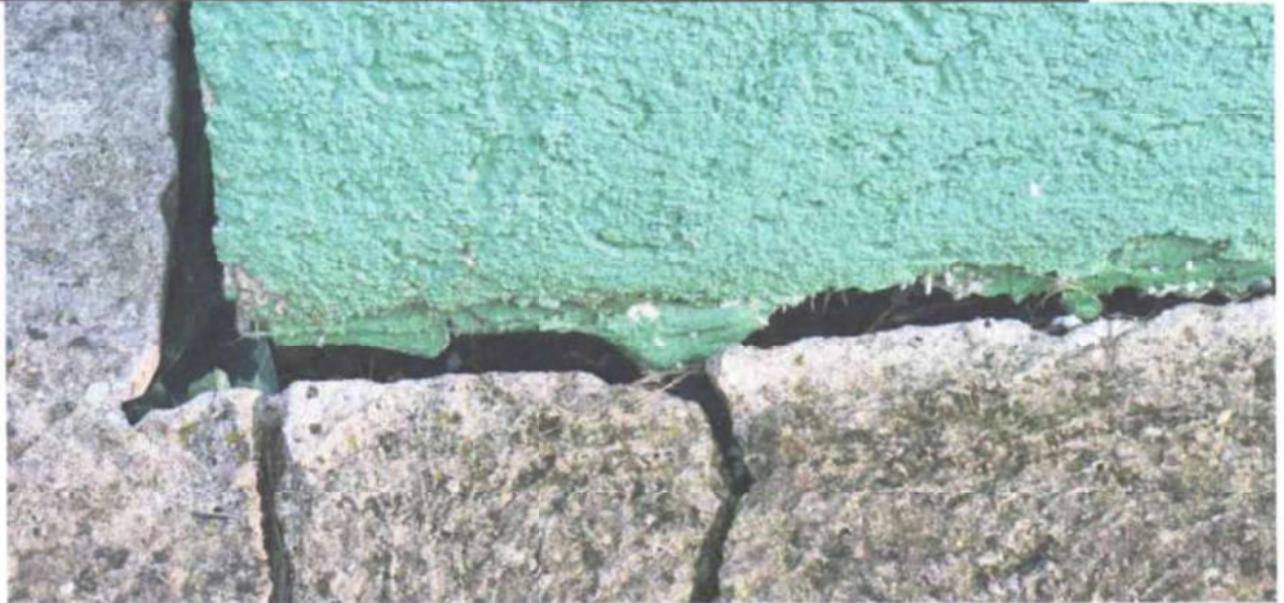
Neetanseitati ale trotuarului de garda – contrapanta + lipsa dop de bitum, panta spre exterior
