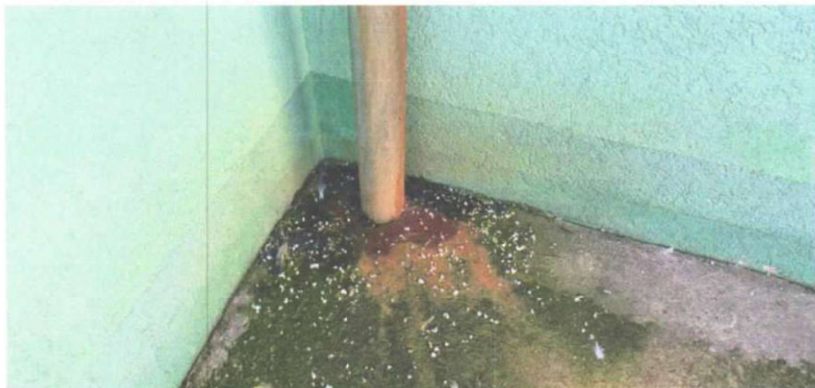
Neetanșeitati ale trotuarului de garda – contrapanta + lipsa dop de bitum, prelingerea apei pe burlan
